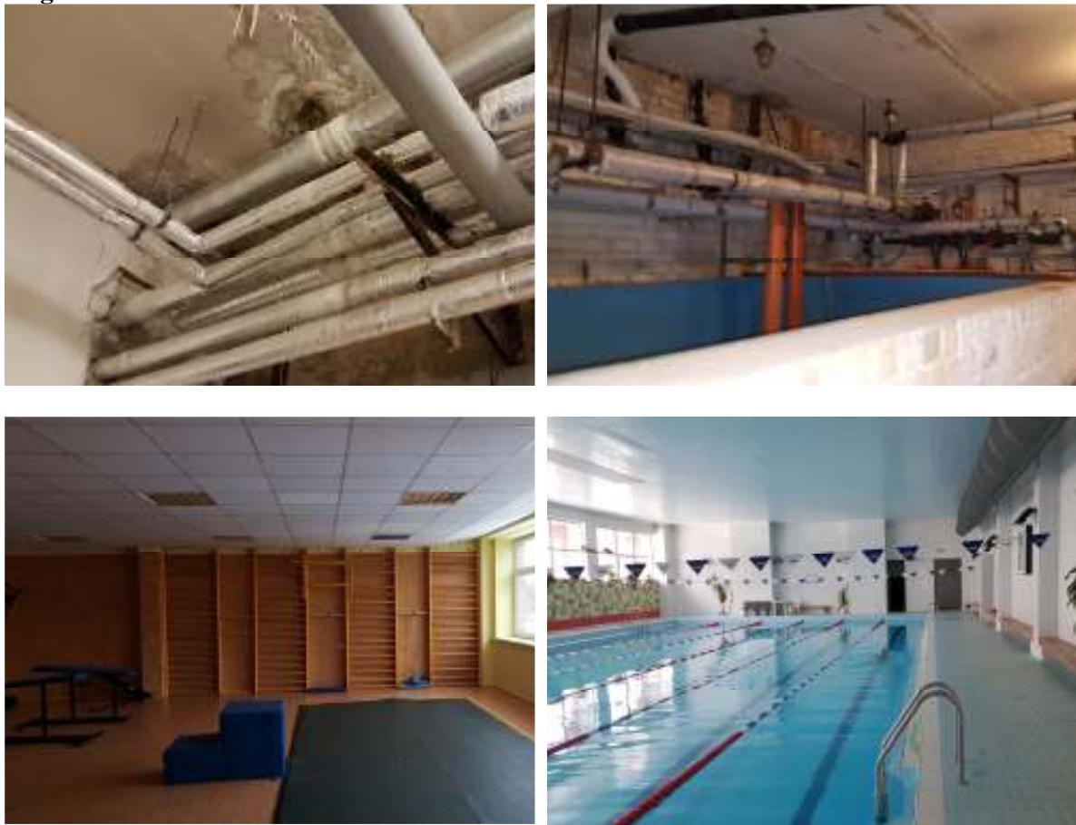
Pav. 3.2 Plaukimo mokyklos baseino inžinerinių sistemų ir vidaus patalpų būklės fragmentai
